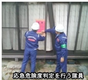
公共施設の被災状況調査
