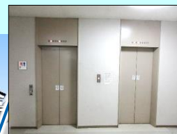
エレベーター
