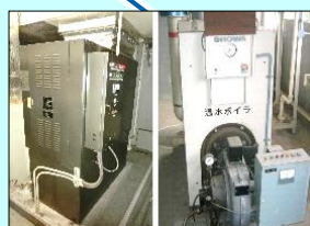
ボイラー(機械室)
