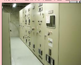
受変電設備(電気室)
