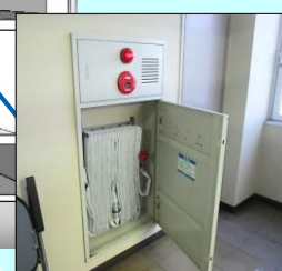
屋内消火栓(廊下)
