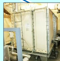
受水タンク(機械室)
