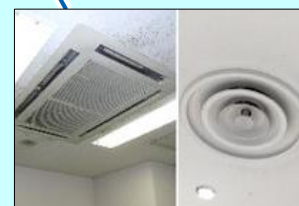
空調機(執務室)
