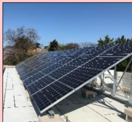
太陽光発電(屋上)
