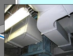
天井内ダクト
