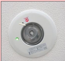
非常用照明(執務室)
