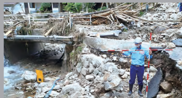
河川の被災状況調査(鳥根県雲南市)
