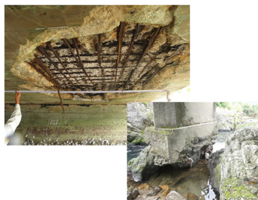
写真1. 1 道路施設の老朽化
