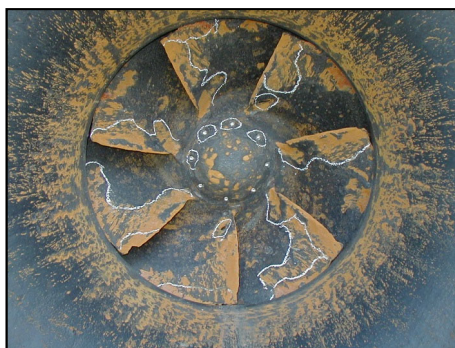
腐食した排水ポンプ場の羽根車
