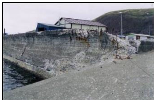
老朽化した海岸堤防
