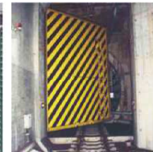
防水扉(トンネル内)
