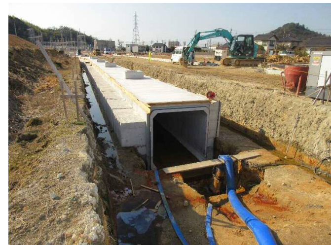
浦ヶ部雨水渠
