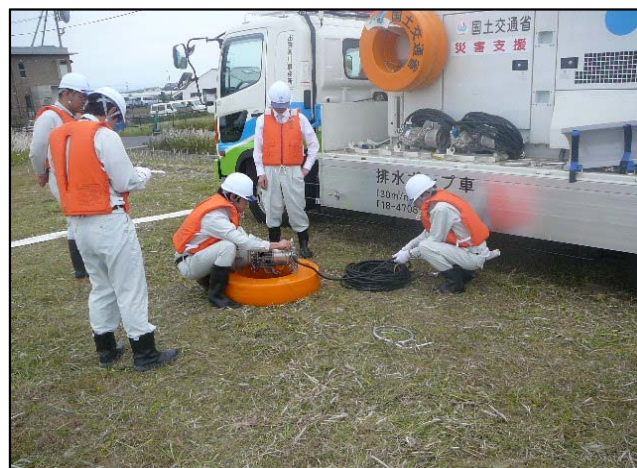
排水ポンプ車（30m 3 /min） ・排水ポンプ電源接続作業
