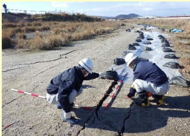
堤防の被災状況調査 (島根県松江市)
