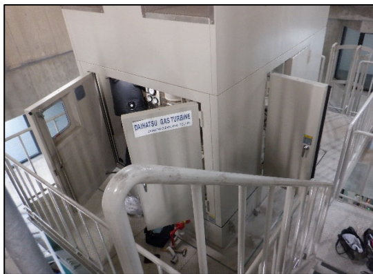
主原動機（ガスタービン）外観
