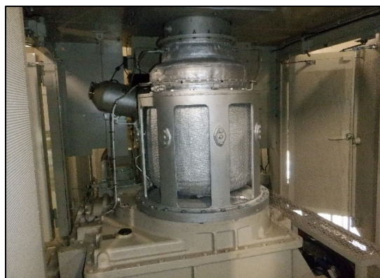
主原動機（ガスタービン）
