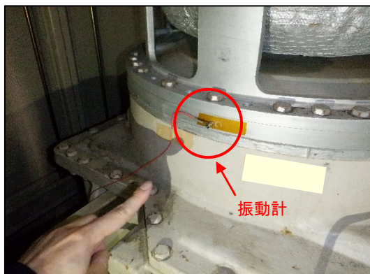
振動計によるポンプの詳細点検
