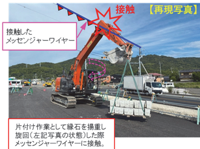
【事故状況写真】
