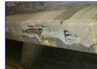
老朽化による損傷事例
