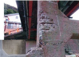
橋脚の損傷(剥離・鉄筋露出)
