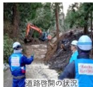
道路閉鎖の状況 (令和6年能登半島地震／石川県輪島市)
