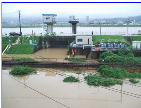
矢口川救急排水機場稼働状況 (H22. 7洪水)
