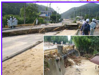
土石流により被災した上勝坂橋(国道262号)
