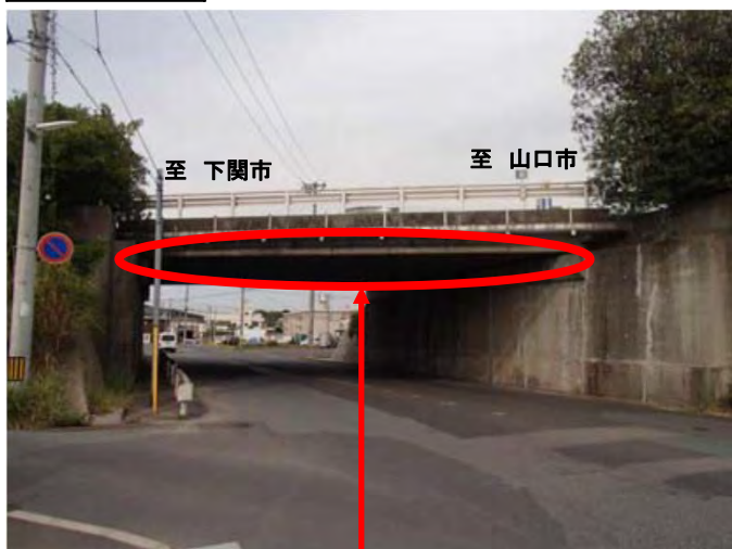
コンクリートの損傷
