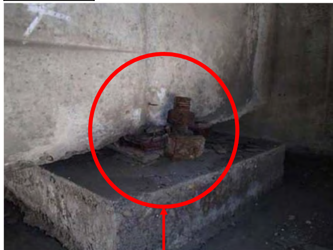
損傷状況写真
