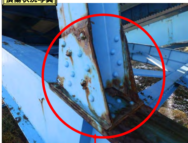
損傷状況写真
