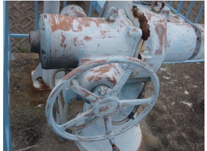
施設の老朽化（樋管の開閉装置）
