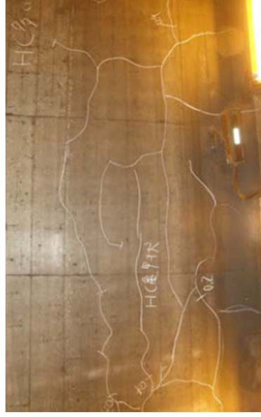
亀甲状のひび割れの例
