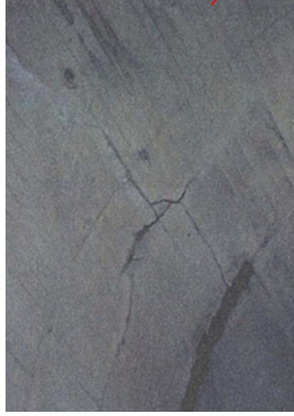
ひび割れでブロック化した例
