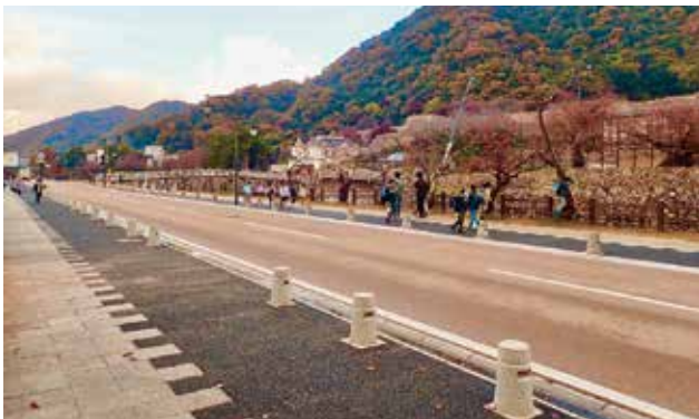
街なみ環境整備事業により美装化、無電柱化、歩道拡幅を行ったお堀端通り。歩道拡幅により、生徒の通学時における安全性が確保された。
