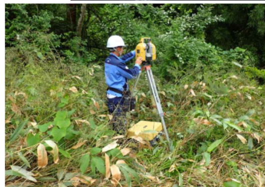
レーザースキャナ設置状況
