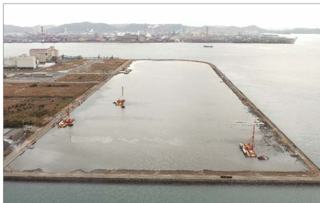
UAV測量(2)範囲 冠水状況 (岡山県倉敷市玉島乙島地先)
