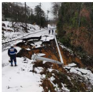
道路被害状況の調査
