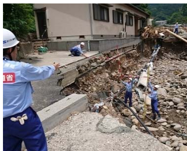
河川被害状況の調査
