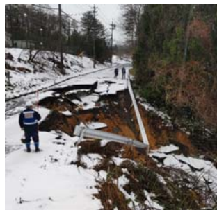
道路被害状況の調査
