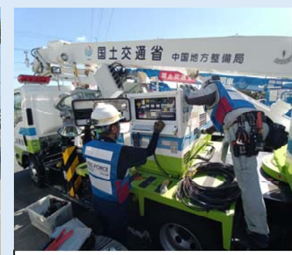
電源支援 （氷川町屋内ゲートボール場）
