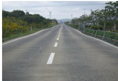
▲国道9号：地震による路面のうねり
