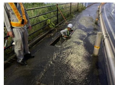
▲国道9号：水路閉塞による路面冠水
