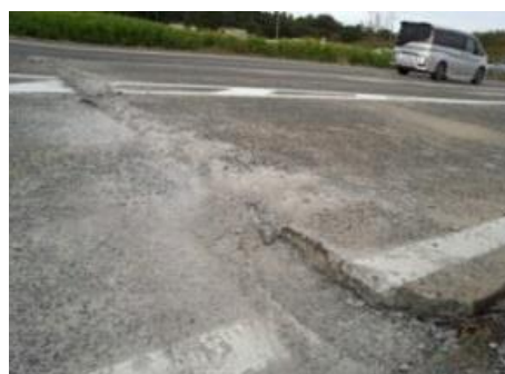
▲国道9号：地震による舗装の損傷
