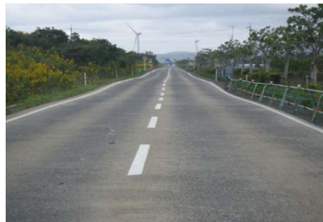
▲国道9号：地震による路面のうねり
