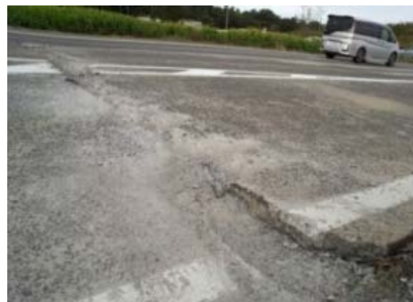
▲国道9号：地震による舗装の損傷
