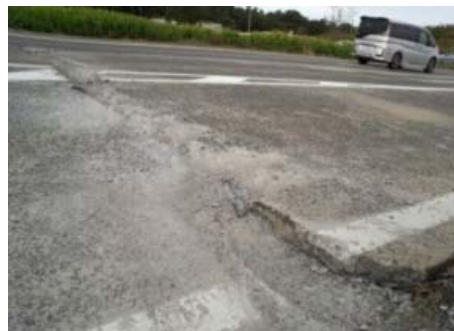
▲国道9号：地震による舗装の損傷
