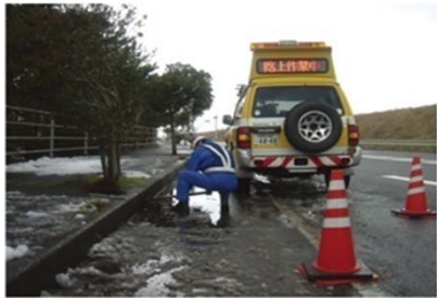
▲ 道路巡回における異常箇所等の発見
