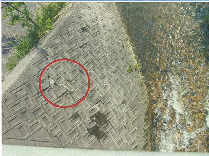
護岸ブロックのひび割れ (天神川左岸)
