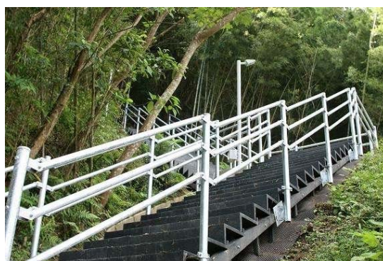
写真-2 プラスチック階段
