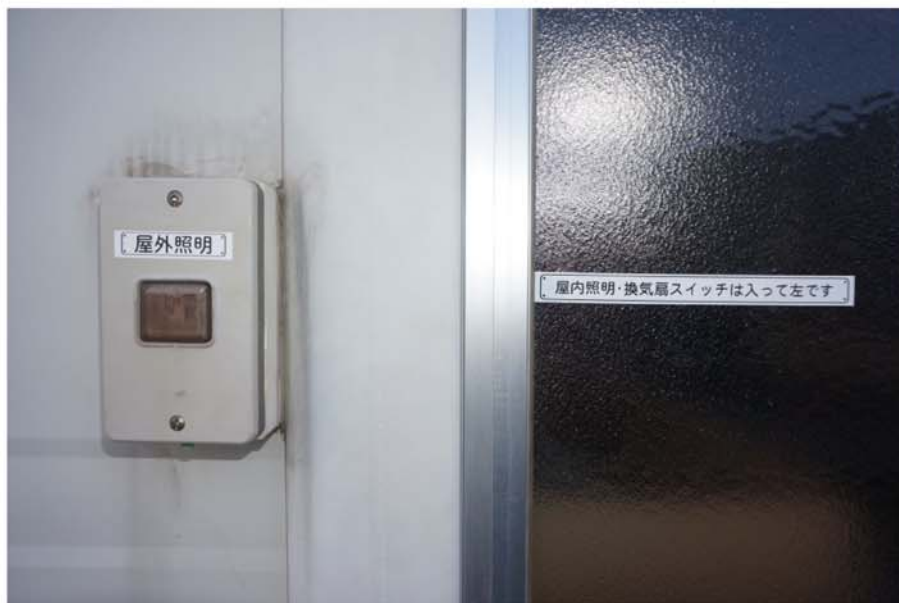
西側の屋内照明・換気扇スイッチ
