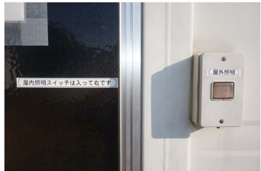
南側の屋内照明スイッチ
