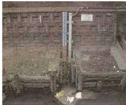
水位計設置状況
