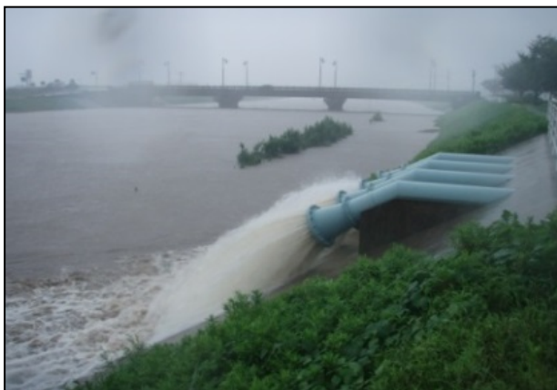
平成23年9月 台風12号時の 和田救急内水排水機場 排水状況 (国府川左岸 0k200付近)
