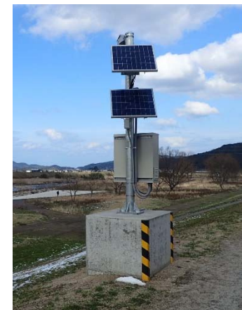
■ 簡易型河川監視カメラ
