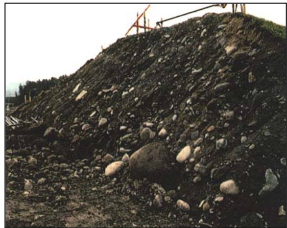
図 2-4 玉石混じりの脆弱な堤体断面(小鴨川)
