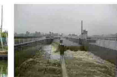
（排水分水ゲート）
