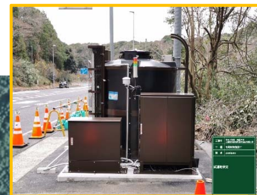
散布装置本体設置状況
