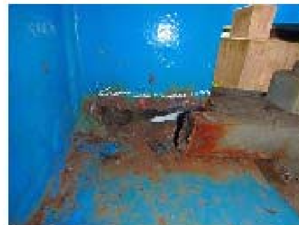
橋梁の損傷状況（雲南市 第1殿河内橋）
