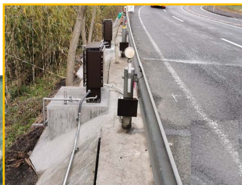
散布(噴射)装置設置状況
