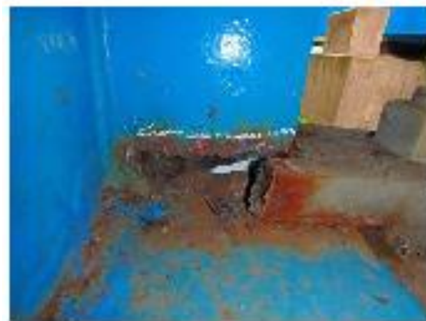
橋梁の損傷状況(雲南市 第1殿河内橋)
