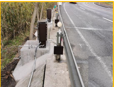
散布(噴射)装置設置状況
