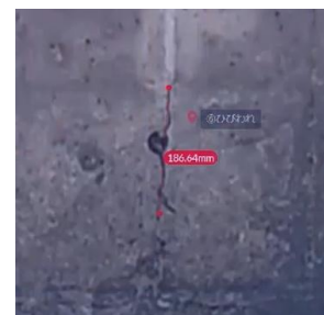
クラウド上で損傷の計測・記録(イメージ)
