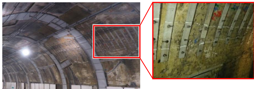
【写真②】赤名トンネルにおける車両の接触による損傷
