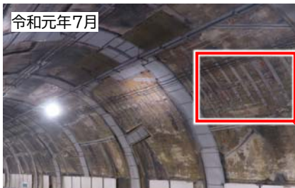
▲赤名トンネルにおける車両の接触によるアーチ部の損傷
