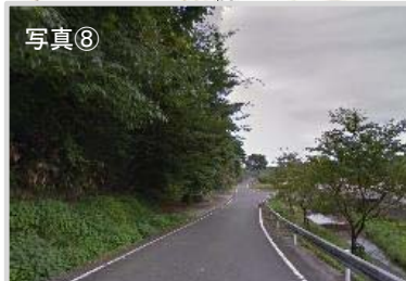
写真⑧ 狭隘区間 植栽繁茂
