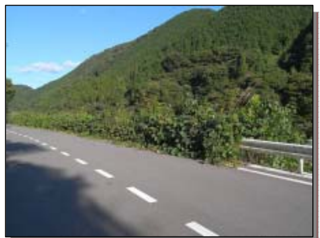
写真 雑草に覆われたガードレール
