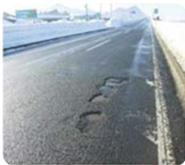
路面の穴ぼこ・ 段差
