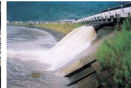
島敷排水ポンプ場運転状況(平成10年10月増水時)
