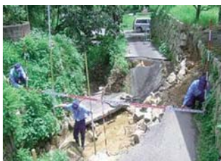
被災状況調査
