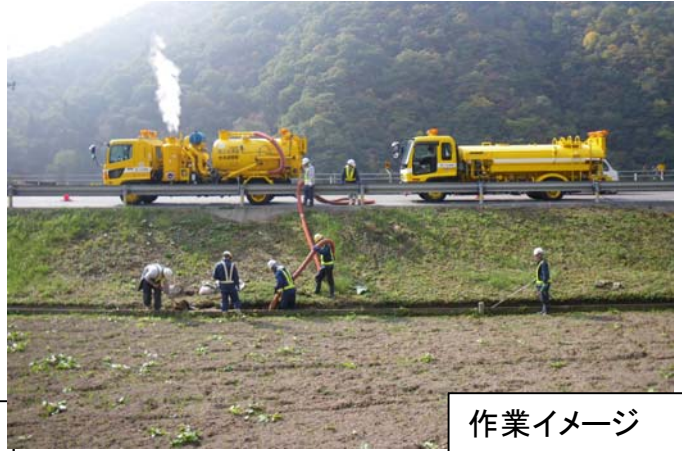
側溝(トンネル内)の堆積状況
