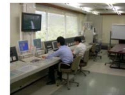
土師ダム操作室
