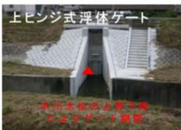
写真 5.2.4 樋門ゲートの自動化
