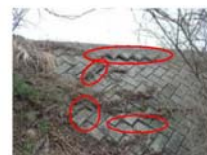
護岸のクラック
