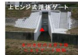
写真 5.2.4 樋門ゲートの自動化
