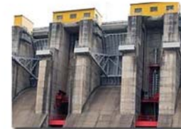
放流施設(土師ダム)
