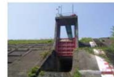
樋門ゲートの劣化
