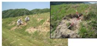
堤防の獣害状況
