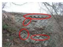
護岸のクラック
