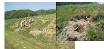
堤防の獣害状況
