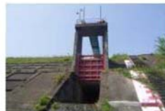
樋門ゲートの劣化
