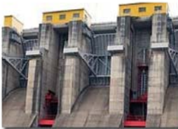
放流施設(土師ダム)
