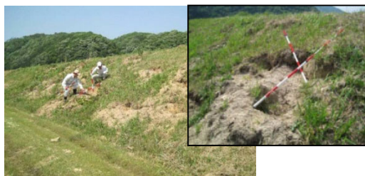
堤防の獣害状況
