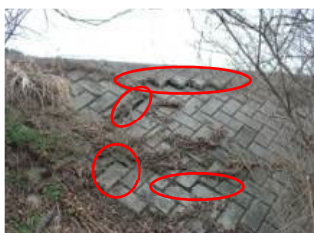
護岸のクラック
