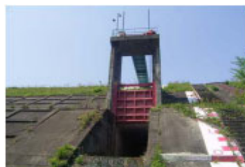
樋門ゲートの劣化
