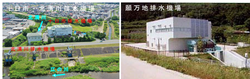
写真 1.2.2 江の川における排水施設
