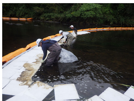
油流出事故への対応 (令和5年9月発生：三次市)
