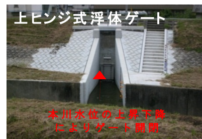
写真 5.2.4 樋門ゲートの自動化
