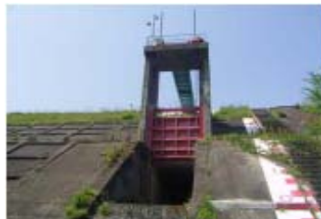
樋門ゲートの劣化
