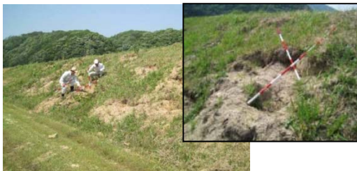
堤防の獣害状況
