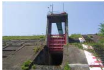
樋門ゲートの劣化
