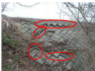
護岸のクラック
