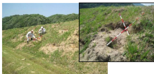
堤防の獣害状況
