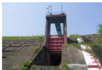
樋門ゲートの劣化
