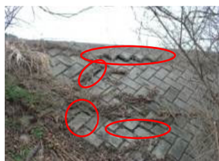
護岸のクラック
